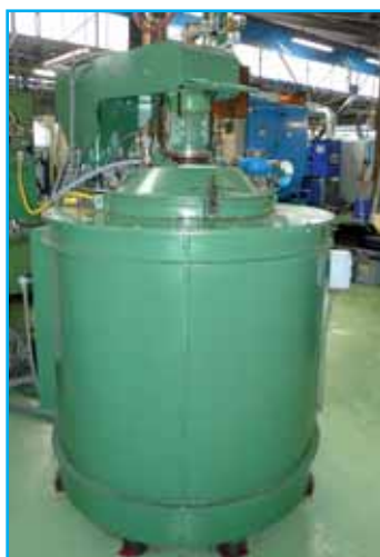
Forno di vaporizzazione Steam tempering plant
